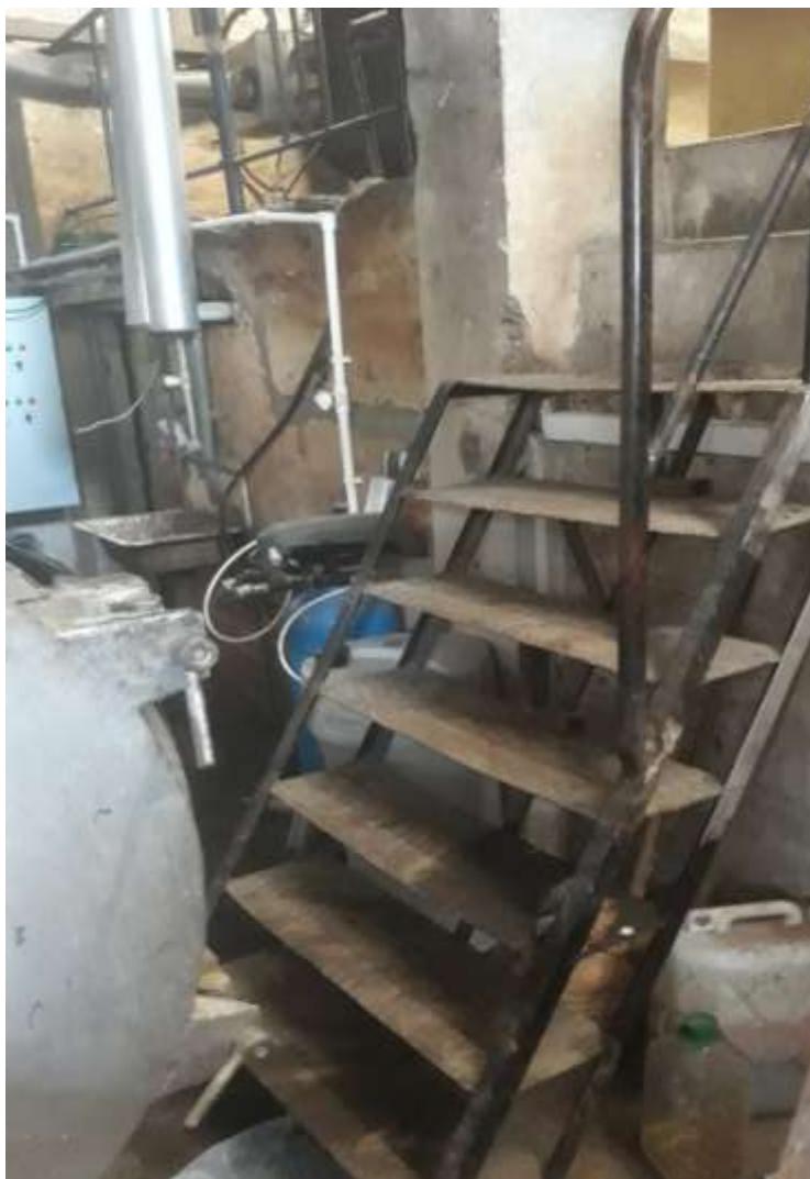
Слика 9 – просторија постојеће котларнице на ЈЛУ- за смештај ТП5
