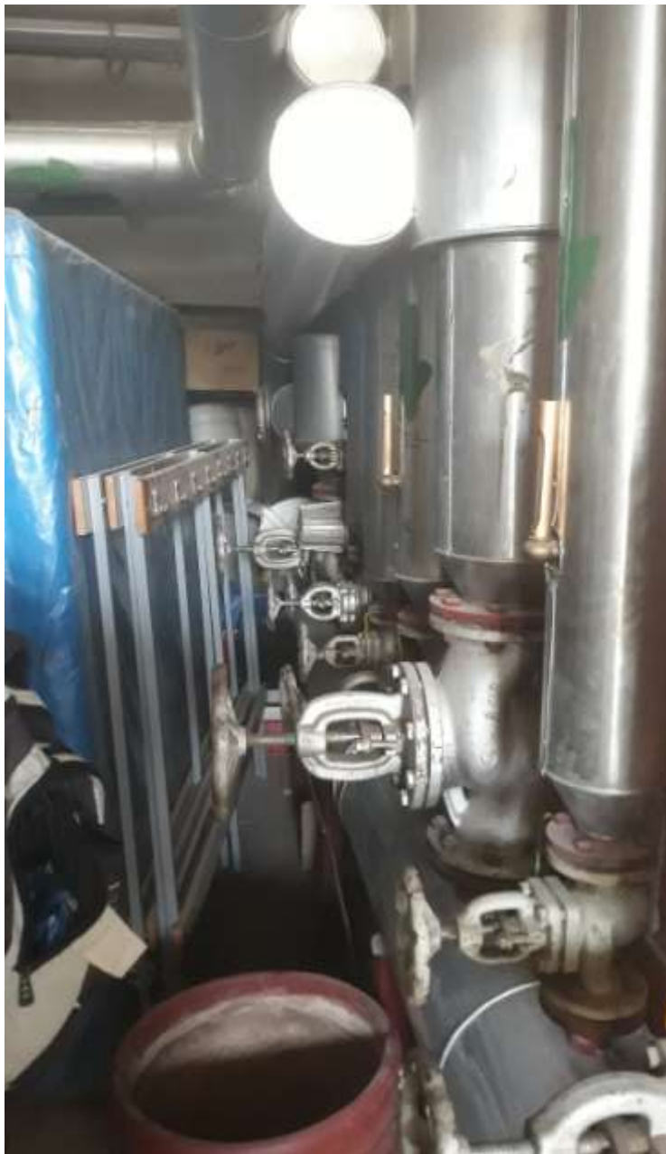
Слика 2 – просторија постојеће подстанице - за смештај ТП1
