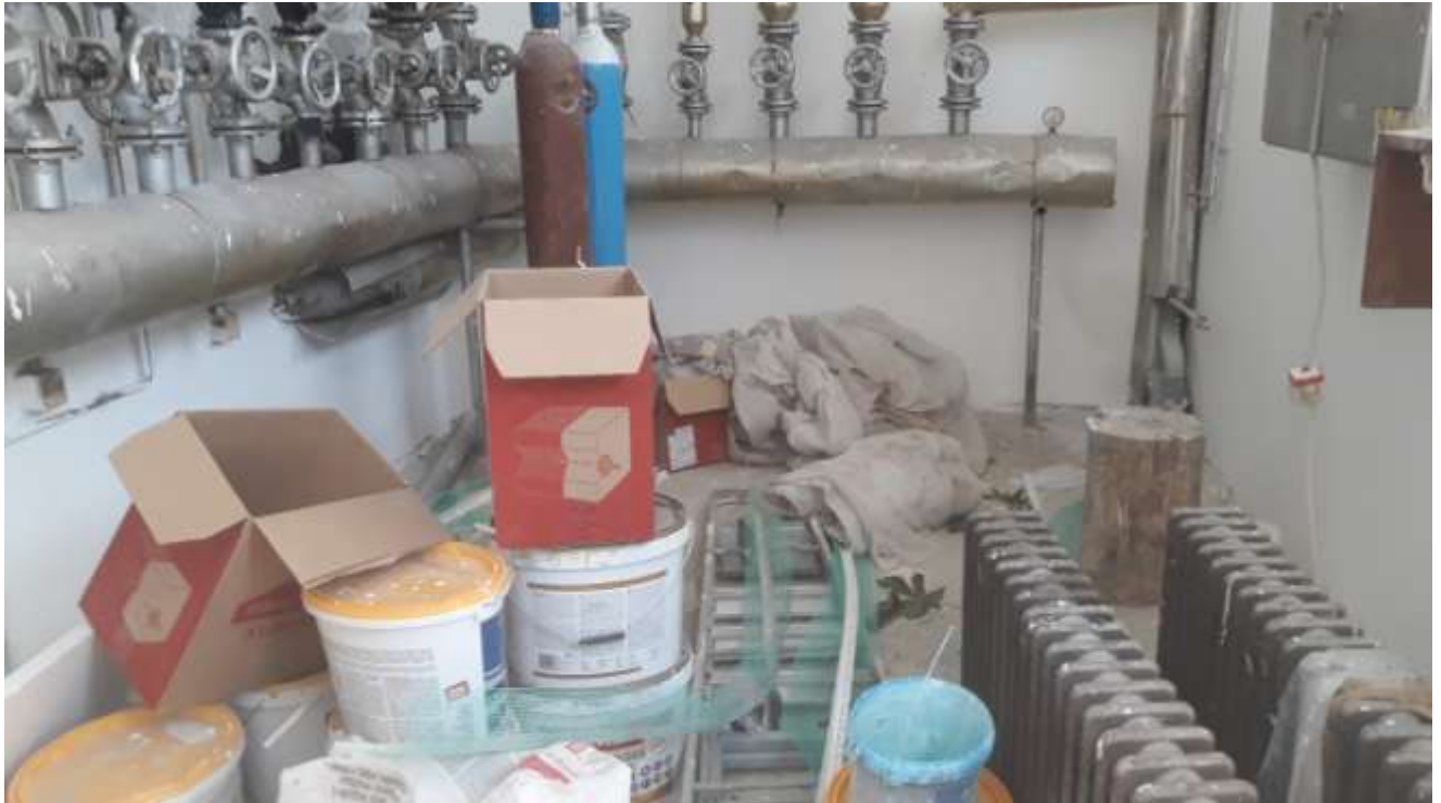
Слика 4 – просторија постојеће подстанице - за смештај ТП2
