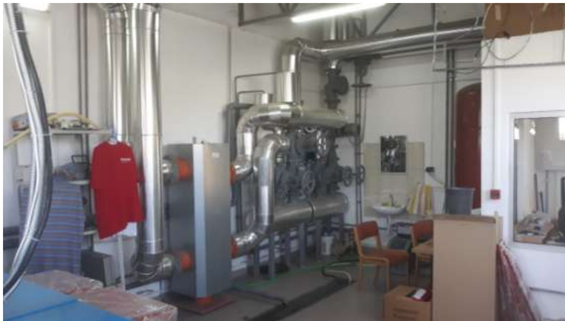
Слика8: просторија постојеће котларнице – за смештај ТП4
